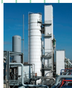
Duży zakład separacji powietrza i system rurociągów
